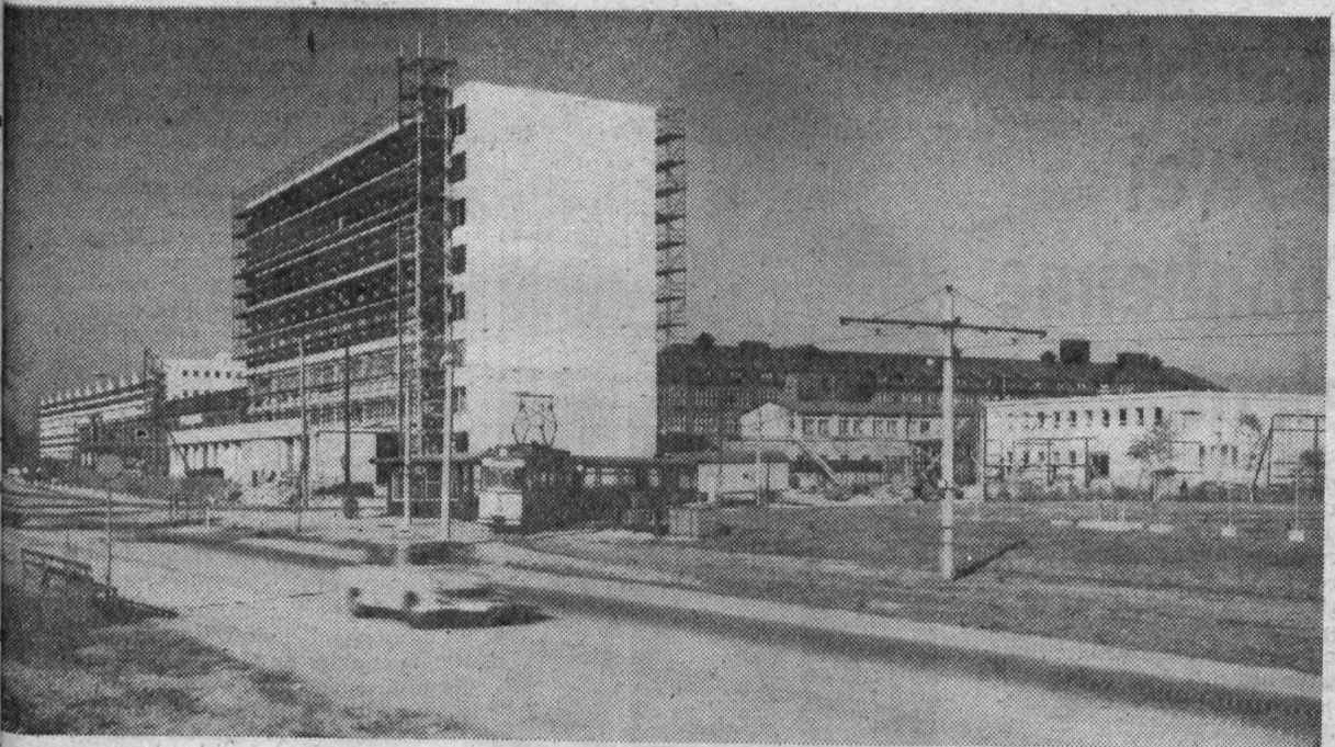
Jahr 1970. Bald fallen die Gerüste. Ab September begann der Einzug in das siebengeschossige Verwaltungsgebäude. Die neue Eingangszone ist noch im Bau, das Gebäude mit Speisesaal und Küche war bereits übergeben.
