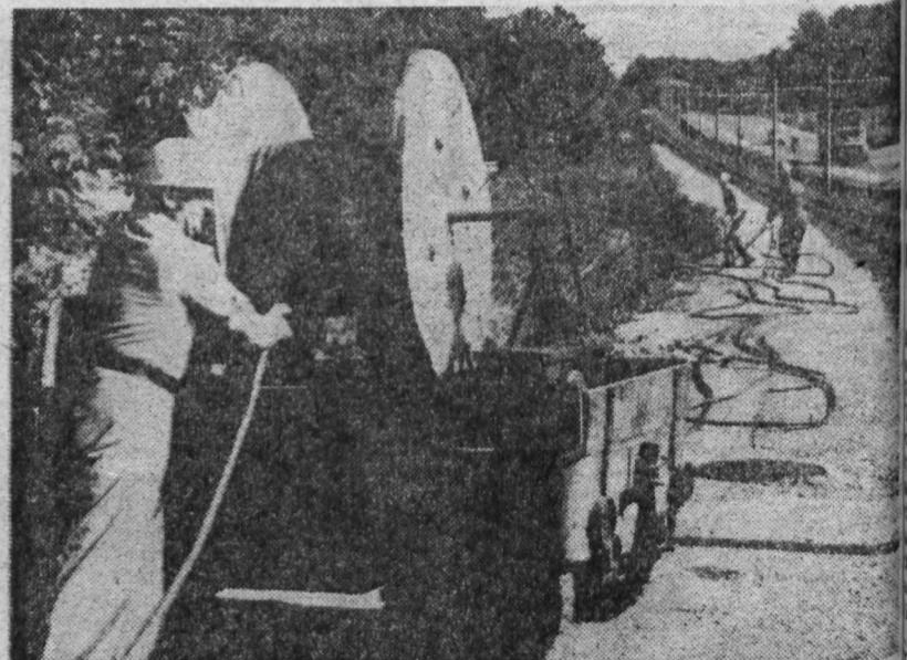
Angehörige des BI-Zuges unter Führung des Genossen Eberhard Knüpfer (links) bei der Bergung eines E-Kabels.
