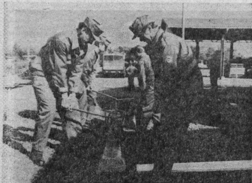
Setzen von Eisenbahnbetonschwellen als feste Unterlage zur Holz- und Kistenlagerung. Im Vordergrund die Genossen Karl Döhler (links) und Richard Trommer.
