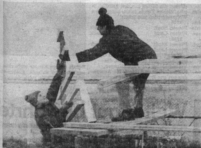
Die Kollegen Wunderlich und Wahler beim Errichten der Sparren für das Schilfdach über dem Grill.
